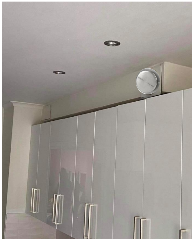
Figur 6 - Godkänd frånluftsventil som frilagts trots ditsatta köksskåp. Att ha byggt in ventilen bakom ett köksskåp eller inuti ett köksskåp är inte godkänt.
