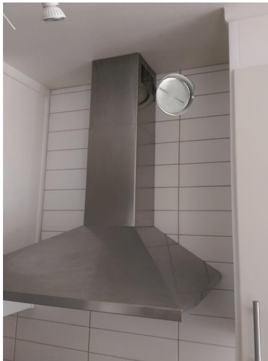
Figur 4 - Godkänd köksfläktinstallation med en kolfilterfläkt och en frånluftsventil (här en tallriksventil) som sitter fritt och inte är överbyggd av exempelvis skåp eller annat.
