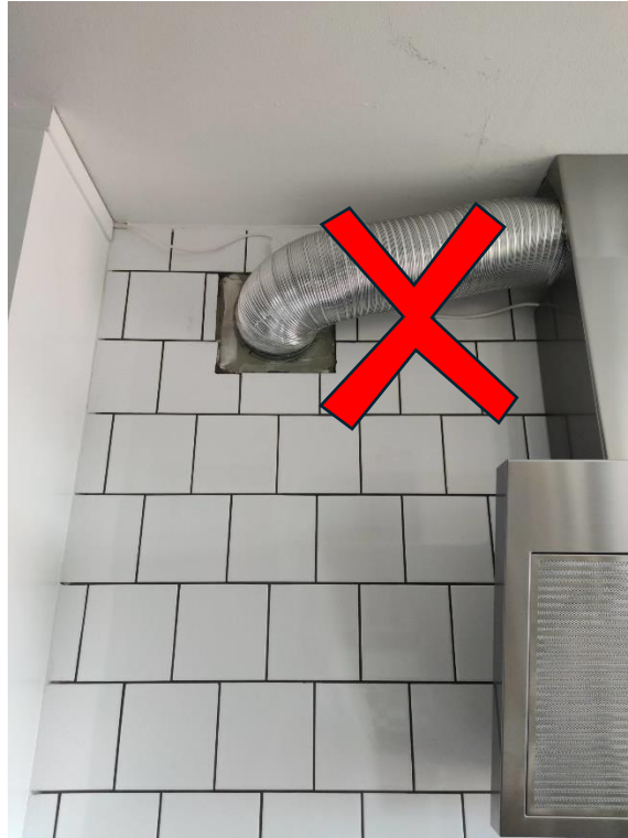
Figur 5 - Ej godkänd köksfläkt som kopplats till frånluftsventilen. För att få godkänt måste kanalen monteras bort och fläkten måste bytas ut till en med kolfilter, som rengör luften inuti fläkten istället för att trycka ut den rakt ut i skorstenen.
